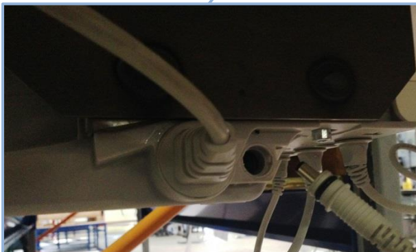
3.1 Ledningen fra batteriet kobles til kontrollboksen
